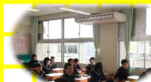
運用開始した中学校のエアコン
