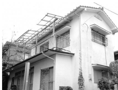
バルコニー屋根剥落
