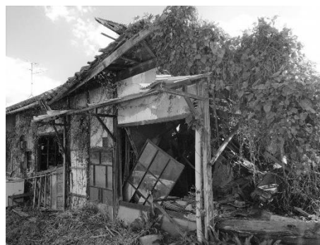
構造材損傷・屋根材剥落・外壁剥落
