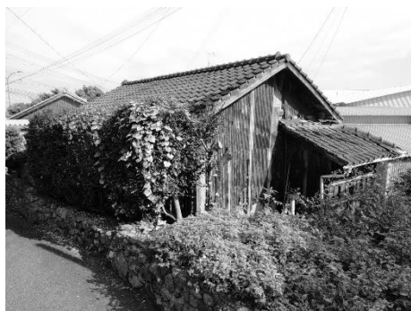
外壁剥落・瓦落下
